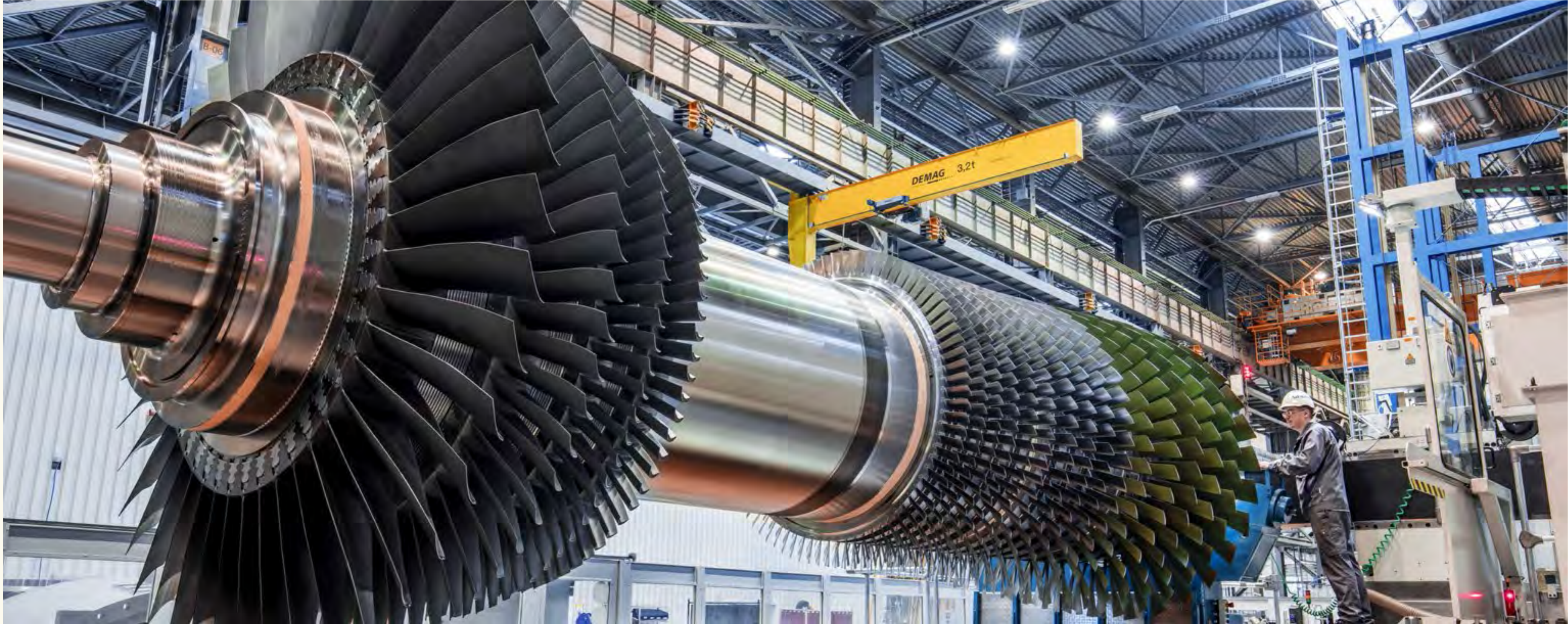
Siemens ist schon mehr als 165 Jahre in Russland aktiv. Heute betreibt es hier mehrere Produktions- und Wartungsstätten, unter anderem für Gasturbinen. | «Сименс» работает в России более 165 лет. Сегодня у компании здесь ряд производственных площадок, в том числе завод по выпуску и сервисному обслуживанию газовых турбин.
