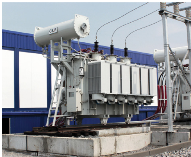
На объекте ПЛП г. Новосибирск, ТДН- 16000/35
