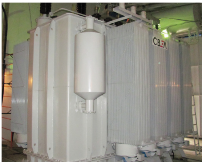
На объекте ОАО «ФСК ЕЭС» - МЭС Юга, ПС Лаура (Сочинский регион)
