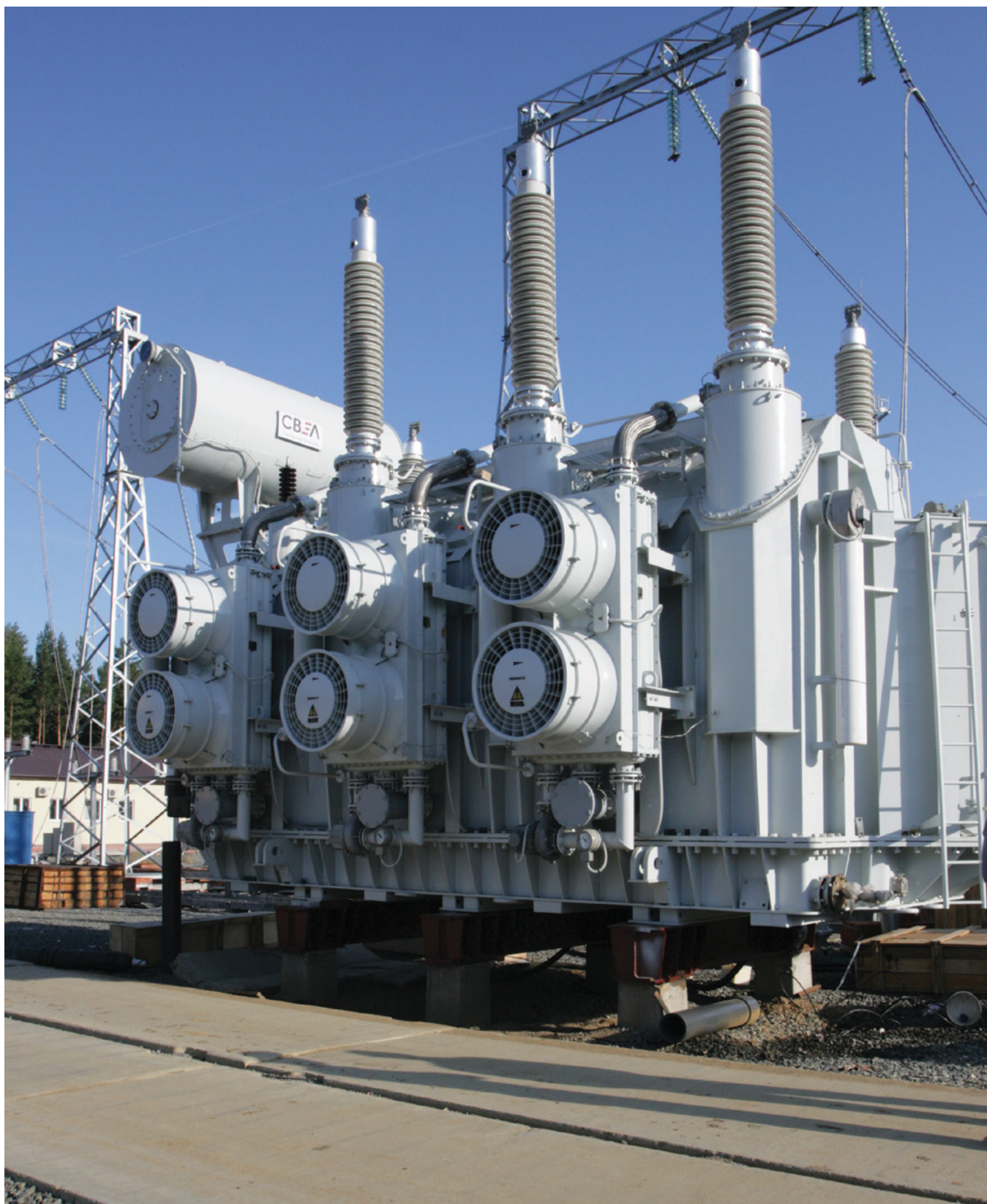
На объекте ОАО «Екатеринбургская электросетевая компания», ПС «Рябина», АДЦТН 250000/220/110
