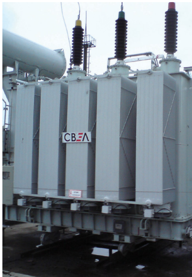
На объекте «МРСК Северо-Запада», ПС «Антоново», ТРДН - 40000/110
